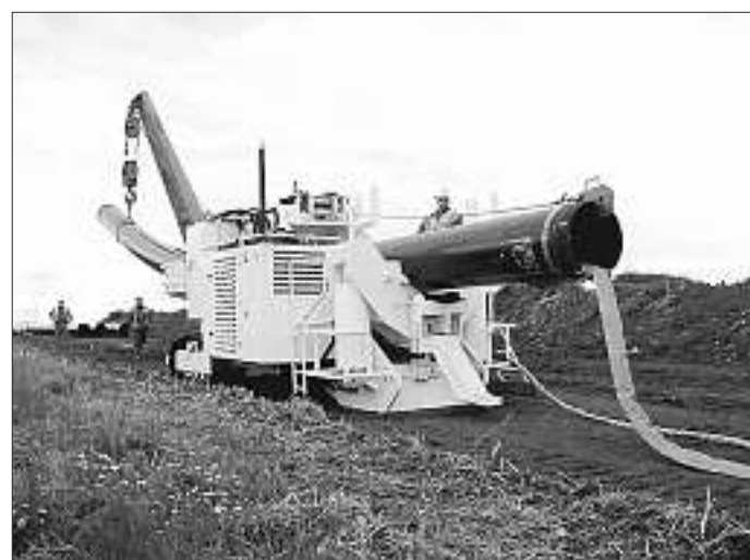
Le cintrage des tubes pour l'adaptation au relief et au tracé est réalisé sur place.
